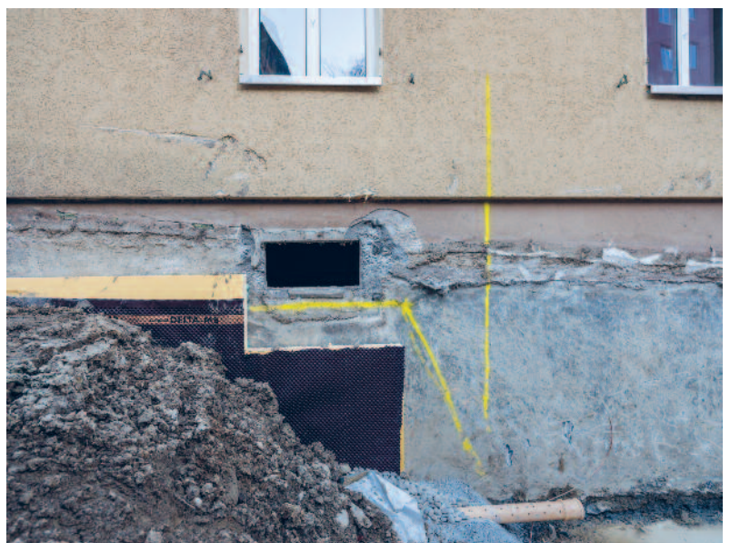
Die Kellergeschosse sind freigelegt, teilweise schon isoliert und mit Sickerleitungen versehen. Der Weg für die energetische Sanierung ist quasi geebnet.
