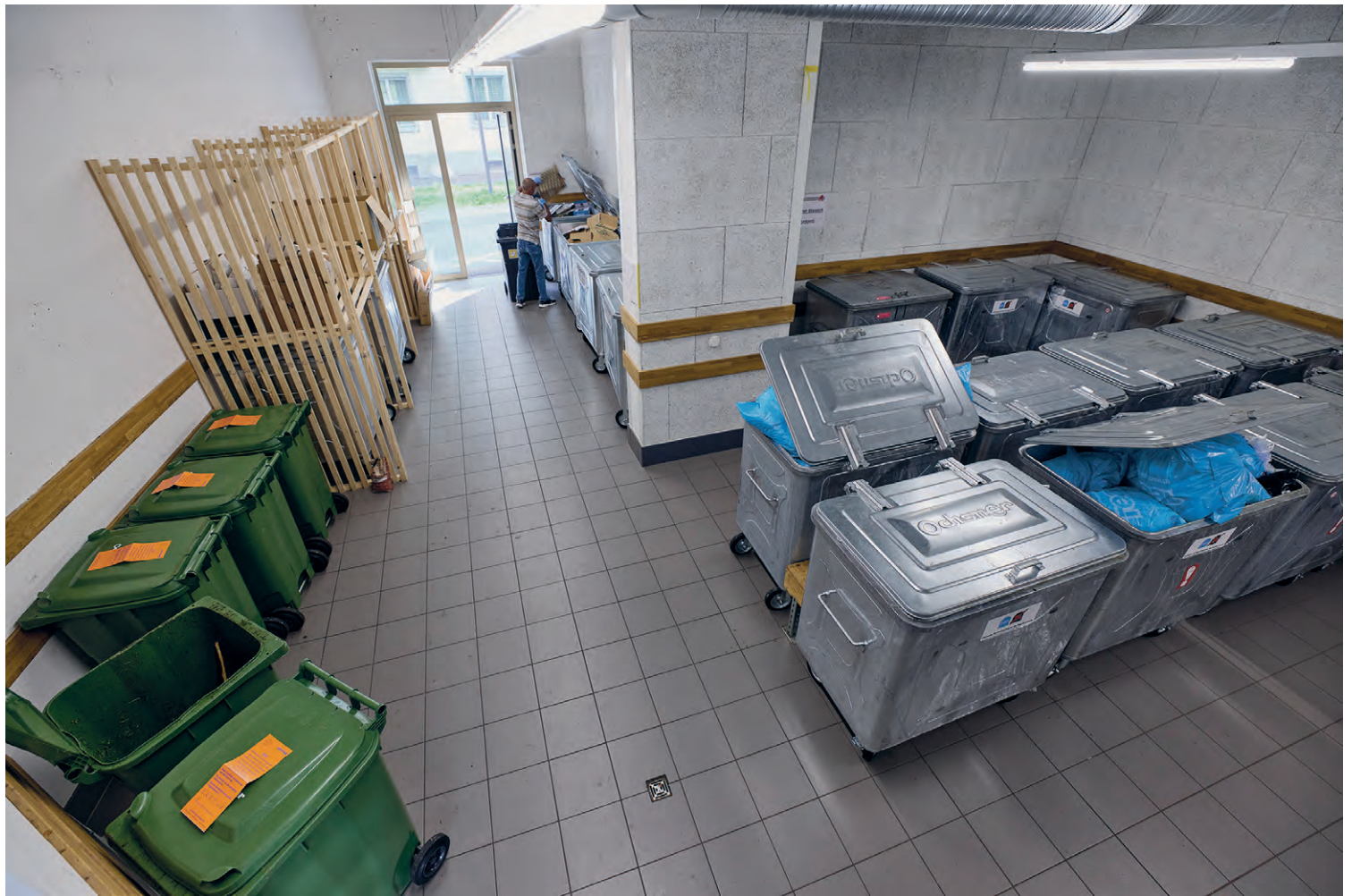
Schön ordentlich stehen sie da, die Behältnisse im Entsorgungsraum der Siedlung Himmelrich 3. Hin und wieder wird hier allerdings Abfall deponiert, der nicht in diese Container gehört und separat entsorgt werden muss.
