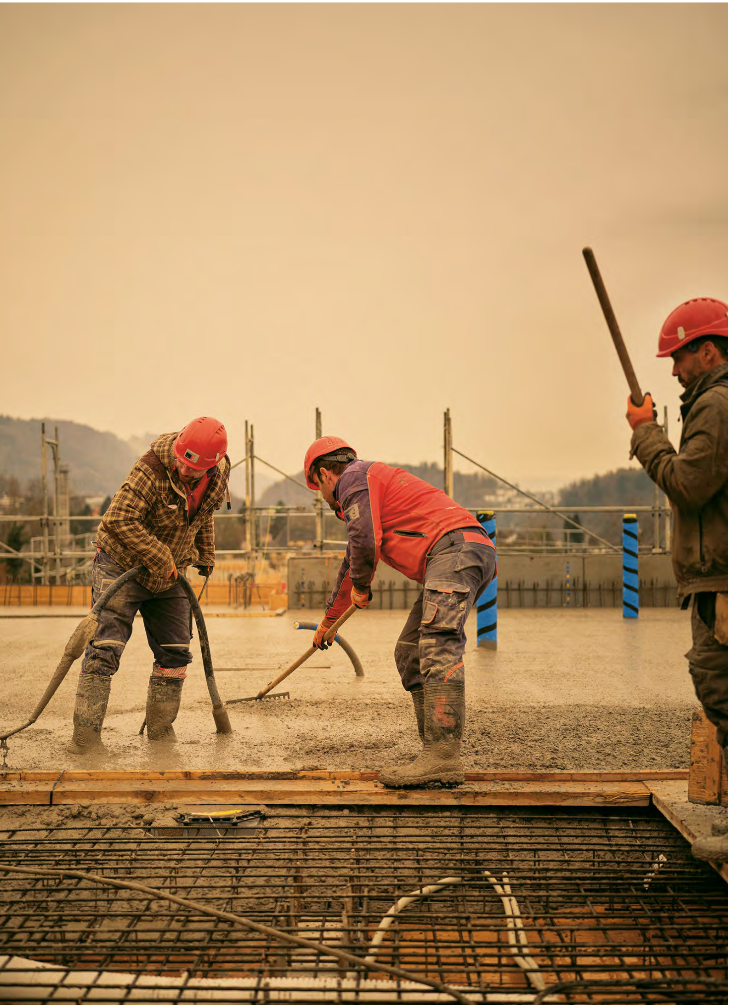
Betonieren unter besonderen zeitlich-meteorologischen Umständen – der Saharastaub sorgt für eine geradezu mystische Stimmung auf der Baustelle.
